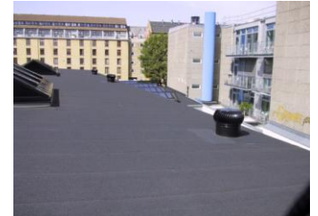
En færdig installeret vindturbiner på et fladt tagpap tag.
