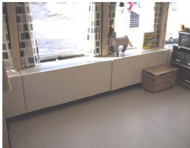
Radiator kabinet i den fulde rumbredde
