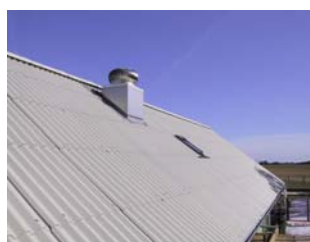
Vindturbine = aktiv udsugning
